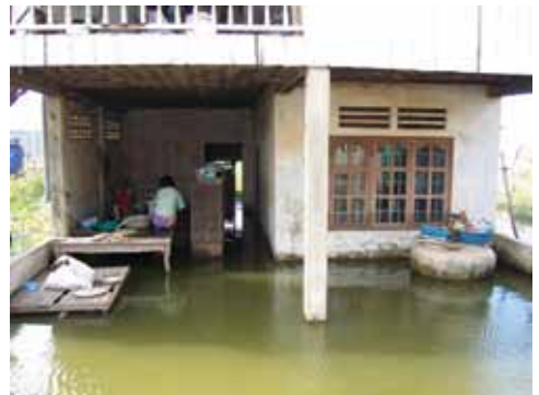
Figur 3. Översvämmat hus. Foto: SEI/IITC 2009. Källa: Men et al 2009.
