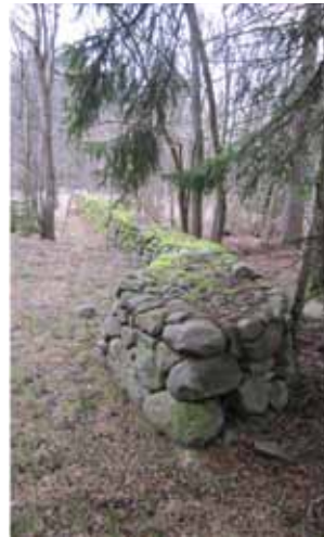
Figur 3. Ett annorlunda avslut. Har den som byggde stenmuren haft sten kvar? Många stenmurar är hela livsverk och bör behandlas med stor respekt.
