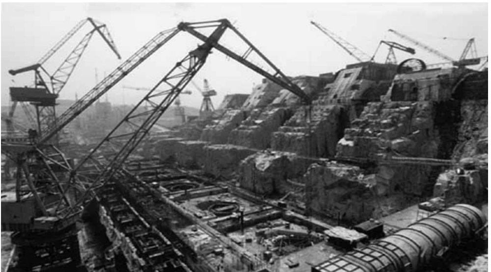
Figur 2. Bygandet av dammen vid Tre klyftors ravin inleddes 1992. På bilden syns delar av dammkrönet och den blivande turbinhallen med sina tilloppstuber.
