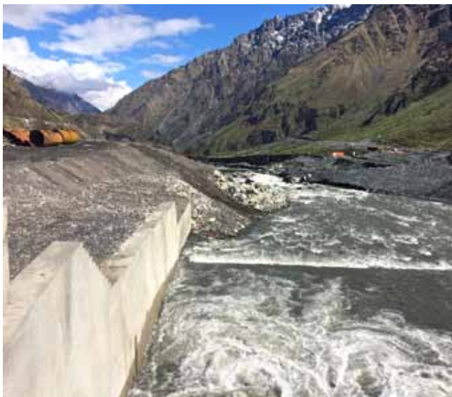
Figur 8. Kanal som byggts vid Dariali HPP för att leda om vattnet i Tergifloden. Foto: Emma Axelsson.
